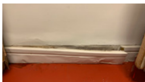
Infiltrations réserve bibliothèque
