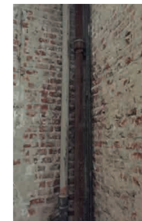
Conduite amiante ciment
